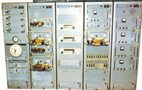
DW-Station Kigali (Ruanda) im Jahre 1969 und heute: Die historischen Empfänger EK 07 mit elektromagnetischer Fernsteuerung und (im mittleren Gestell auf dem Farbfoto) die modernen EK 070.
